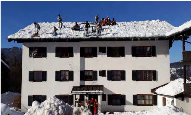
Einheiten beim Räumen eines Wohnhauses
