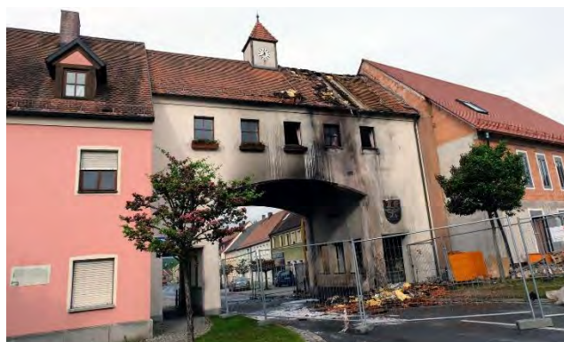
Schaden durch den PKW-Brand am Oberen Tor
